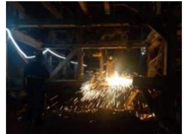
Treballs de tall amb bufador per desmantellament i transport fins al pou de Guinardó per evacuació a superfície de la tuneladora NFM.
