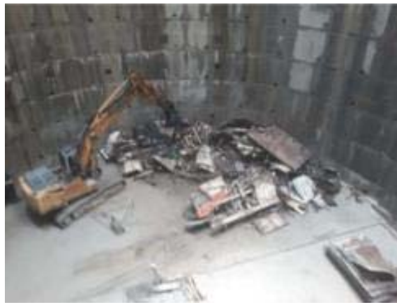
Abassegament provisional d'equips i especejament d'estructura del carro VII del backup de la tuneladora a Guinardó.
